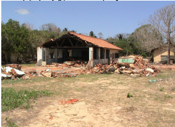
既存被災校舎(2005年2月)
