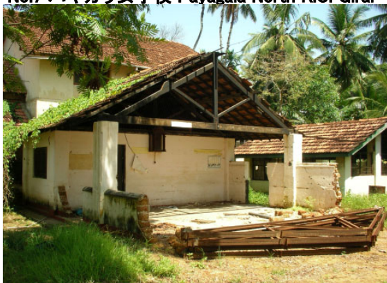
既存被災校舎(2005年9月)
