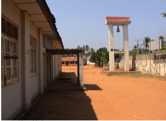
既存被災校舎(2005年2月)
