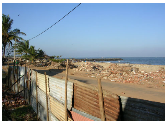
被災施設(境界塀)
