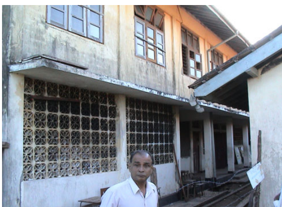
被災施設(2階建校舎・浸水)
