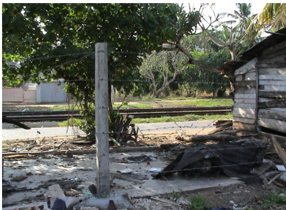
被災箇所(境界塀)
