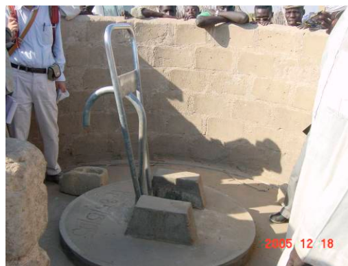
写真-29 Mélemélé II 村の足踏み式ポンプ設置深井戸 クウェート基金の融資で今年建設されたバルニエ製足踏みポンプ付深井戸、現在故障中で修理人を待っている。
