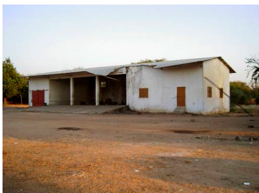
写真-37 水利局アティ基地 老朽化している。現在はあまり使われていない。
