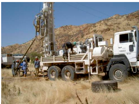
写真-7 Télélé 村の深井戸掘削現場 KfW-AFD-FED の資金によるプロジェクトでは仏国企業の FORACO 社が掘削している。リグは同社製 HV2000 で 250m まで掘削可能。チャドに支店の FORACO TCHAD 社がある。
