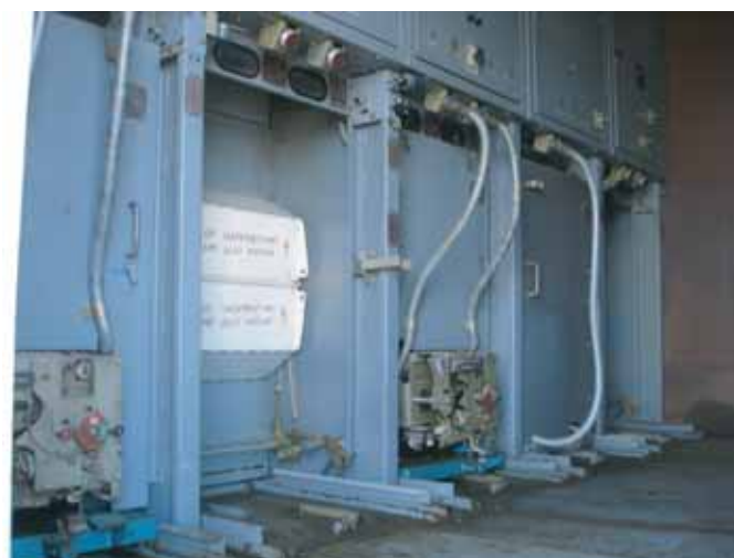
10 kVキュービクル内部
