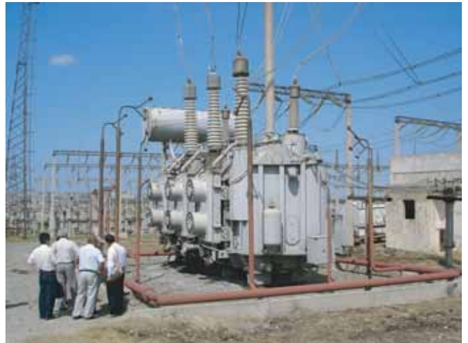
200 MVA主変圧器2号器
