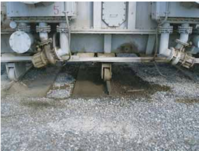
主変圧器2号器の漏油状況
