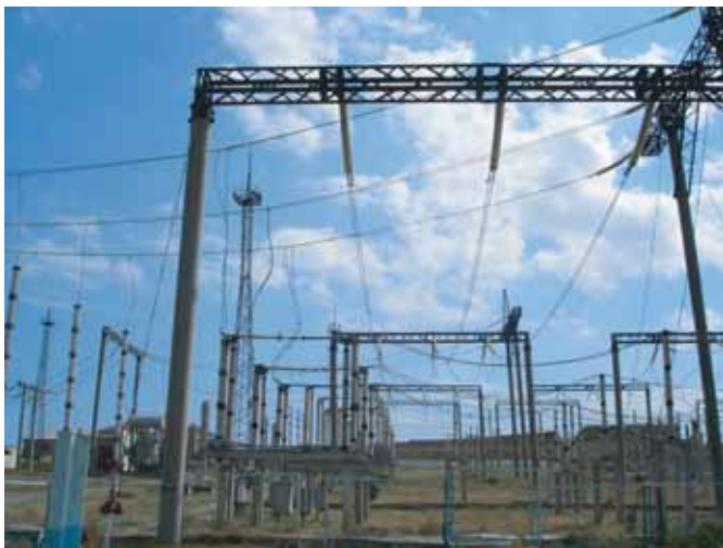
ムシュビク変電所: 220 kV開閉設備
