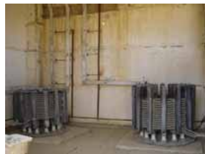
写真-2 建屋内の直列リアクトル
