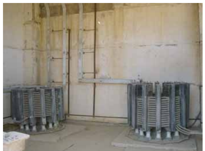
10 kVリアクトル (建屋内の3隅に3台設置されている)
