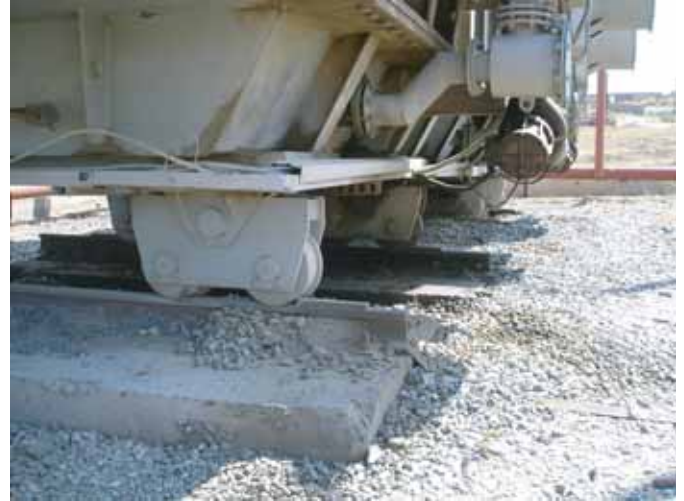
主変圧器2号器の基礎 (コンクリートの一部が欠けており補修が必要)
