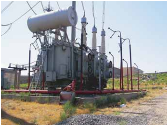
200 MVA主変圧器1号器
