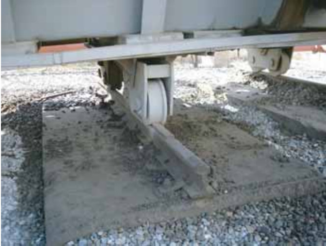
主変圧器1号器の基礎 (一部鉄筋がむき出しになっており補修が必要)
