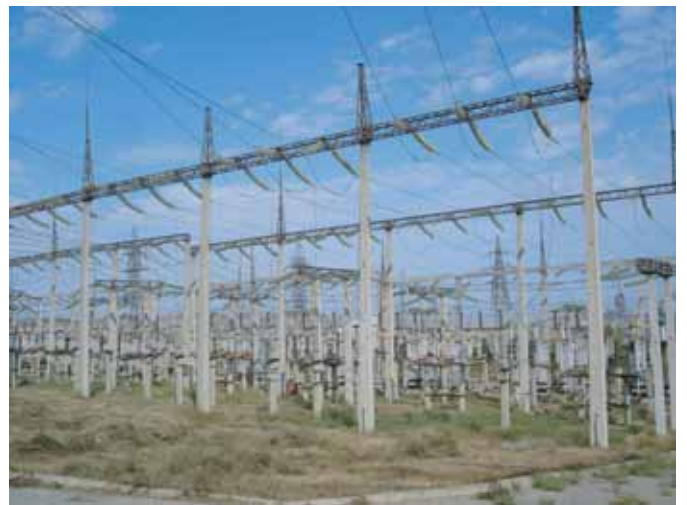
ムシュビク変電所: 110 kV開閉設備
