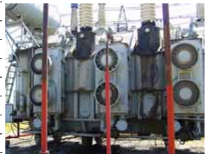
写真-1 変圧器の漏油痕
