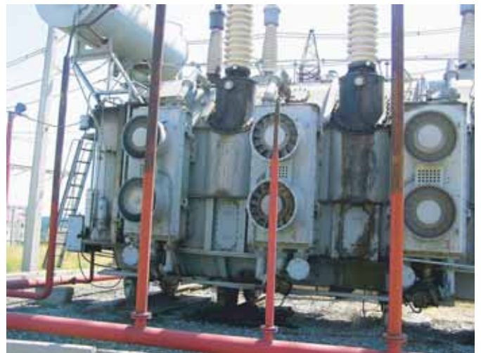
200 MVA主変圧器2号器の老朽化状況 (漏油痕、錆が多い)
