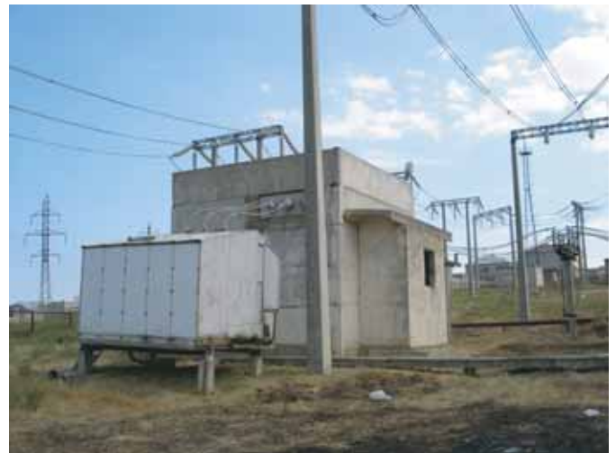
10 kVキュービクル(手前)と リアクトルを設置している建屋(奥)
