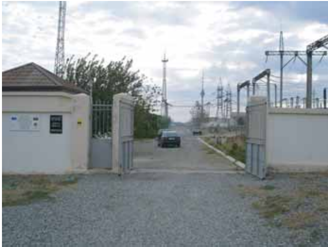
ムシビク変電所のメインゲート (変圧器の搬入時には門柱の撤去が必要)
