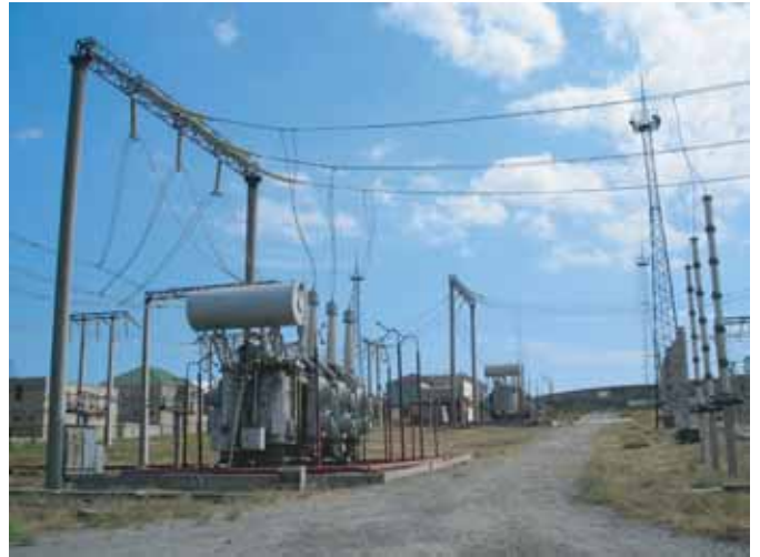
更新対象の主変圧器 (手前が2号器、奥が1号器)
