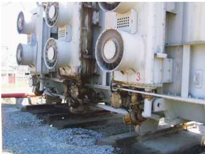
200 MVA主変圧器1号器の老朽化状況 (漏油痕、錆が多い)
