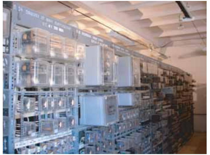
主変圧器用の保護継電器
