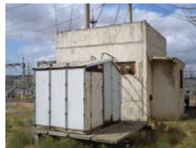
写真-3 10 kV キュービクル
