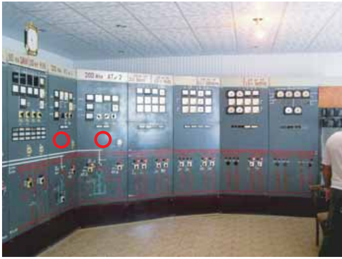
制御室内の監視制御盤 (○印が200 MVA主変圧器の制御盤)
