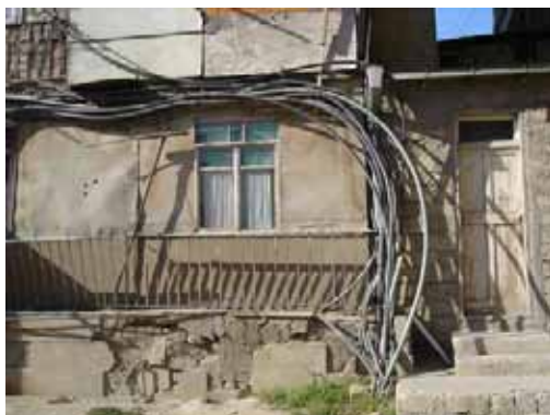
写真-6 違法接続の電力ケーブル
