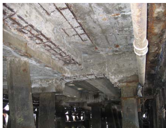
床版部分の下端側のコンクリートが剥離
