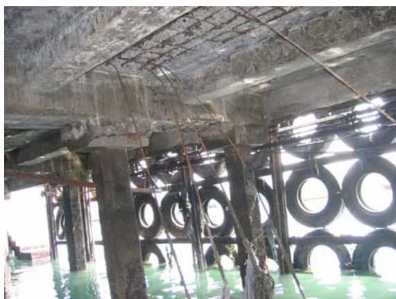
上部工の床版部分の下端側の配力筋が破断
