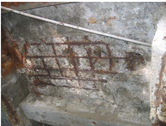
既存棧橋の老朽化状況 （既存棧橋の下端面は、コンクリートの剥離が認められ、老朽化が極度に進行している）
