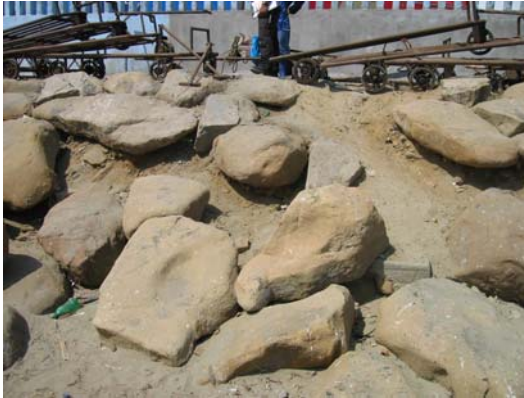
既存栈橋周辺の被覆石（被覆石の欠落）
