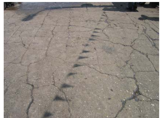
既存棧橋の老朽化状況 （既存棧橋床版部分は、コンクリートの中性化によるクラックの発生が認められる）
