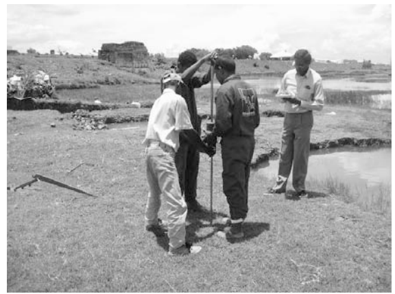
代替案1、Nd.4地点で土質試験実施中の様子。ここは軟弱地盤地帯。
