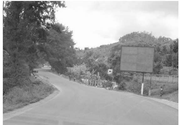
国道2号線の地方部区間。半径の小さな曲線区間が多い。車道の舗装幅員は6m。
