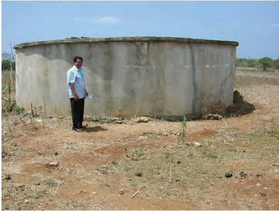
Binakas 貯水タンク
