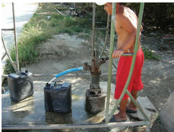
Balikyias 上水道施設（ポンプ）
