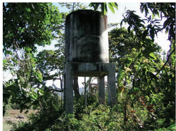
Balikyias 上水道施設（貯水タンク）
