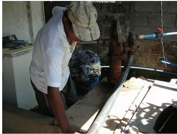
Agwakayan 上水道施設（井戸及びポンプ）
