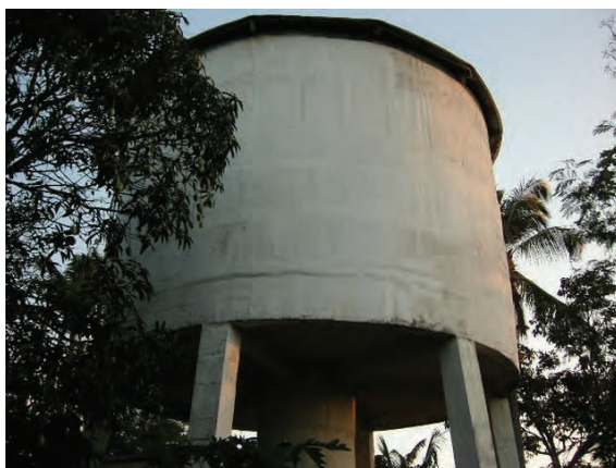
Tagbac 上水道施設 (貯水タンク)
