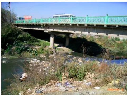
写真 (9) ハヌマティ橋の下流側(ドブ川状態)。
