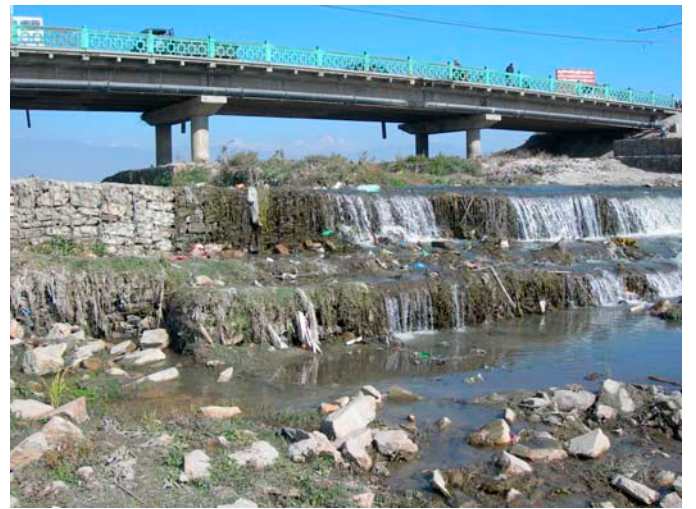
マノハラ橋下流部。橋脚洗掘防止のため設けられたチェックダムおよび生活廃水で汚れた河川。
