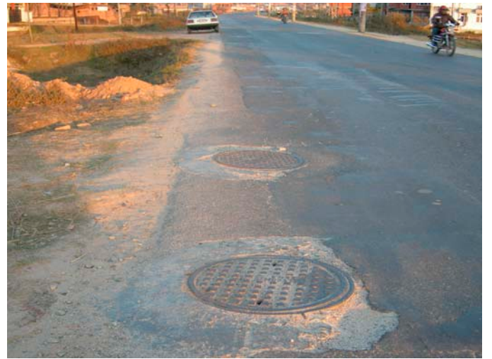
地下埋設物。電話線が対象道路の地下に埋設されている。舗装面もパッチワーク補修が見られる。
