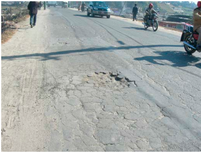
対象道路は舗装厚も不十分のため、ひび割れ、剥離など損傷が著しい。
