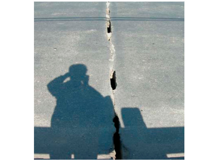
マノハラ橋の目地部。一度改修したが再度損傷を受けて空隙が広がったものと思われる。
