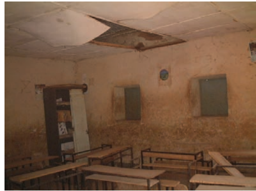
(天井破損と壁からの雨漏り)
