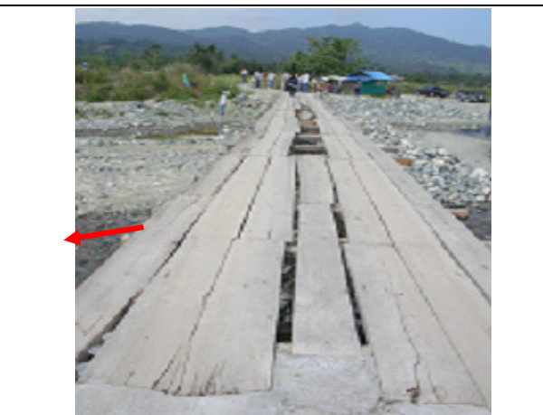
Bazal 橋の床版 (一部床版が剥がれている)
