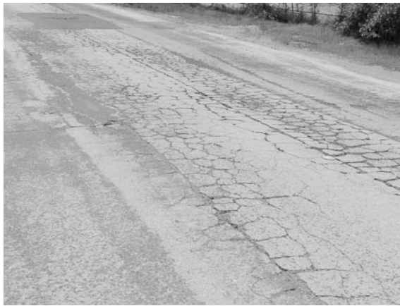
各所にみられる Alligator Crack
