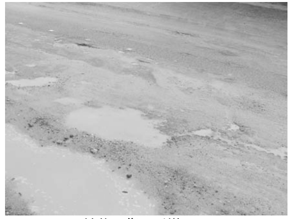
舗装の傷みが激しい
