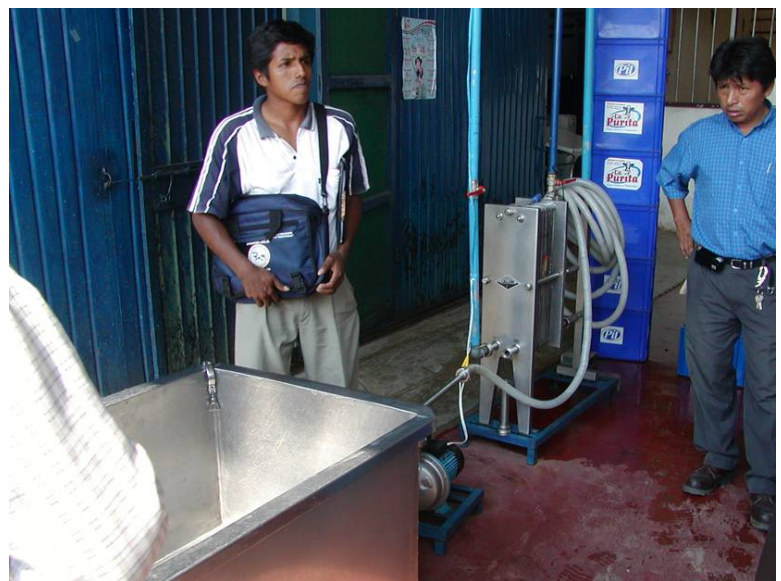
ヤパカニ牛乳生産者協会の牛乳処理 工場 搬入タンクと冷却装置
