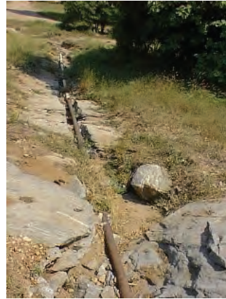
むき出しの配水管
