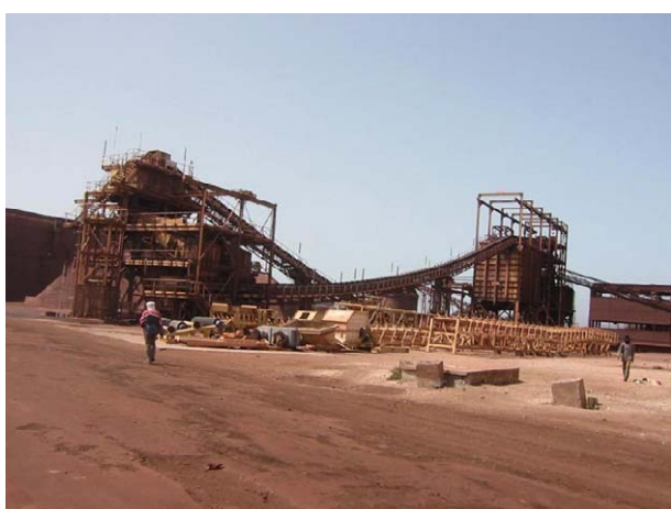
5. 大きな2つの破碎プラントが並んでいる。鉱石は4段階の開・閉回路工程を経て粒度6mm以下にされる。破碎工場は内外は非常に細かい鉄粉が舞い、従業員に影響する。プラントの裏は船積み用貯鉱スタックパイルが見える。
