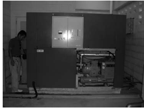
製氷機・冷蔵庫の二階にある機械室 (シャトーブレール、撮影日：2005年8月9日)
