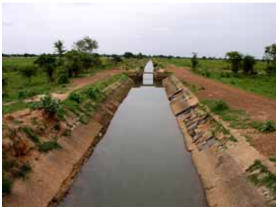
幹線水路（法面崩壊が見られる）
