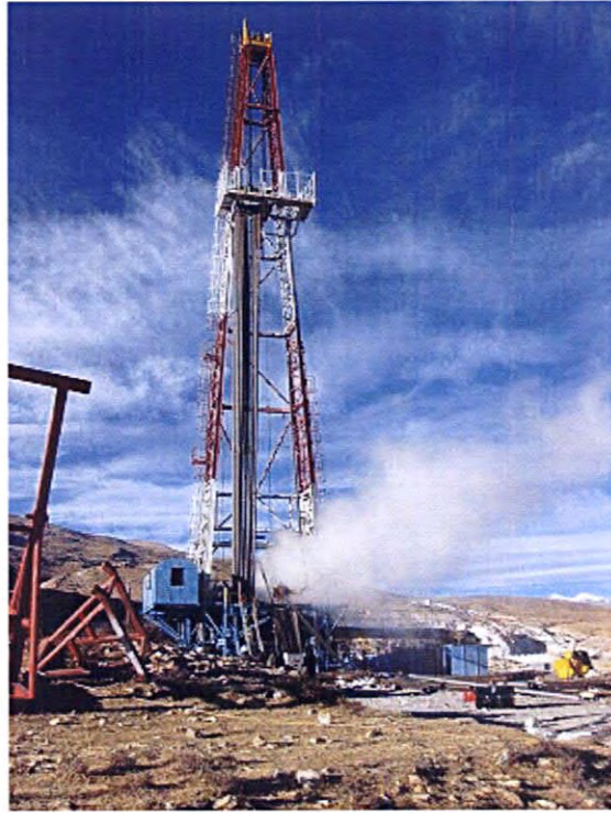
钻机和引喷的全景：用空压机向井内送入高压空气后，井口开始喷出蒸汽和热水。
