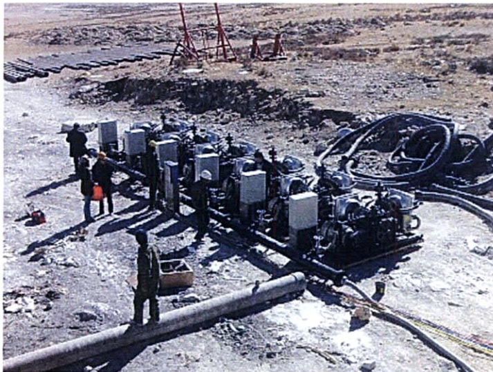
高圧コンプレッサーは6台を並列に並べている。 電動モーター駆動である。
