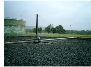
写真-14 散水ろ床
