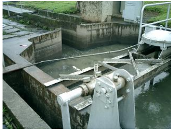
写真-12 沈砂処理
