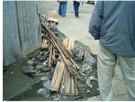
写真6-13 ゴミ流入による目詰まり
