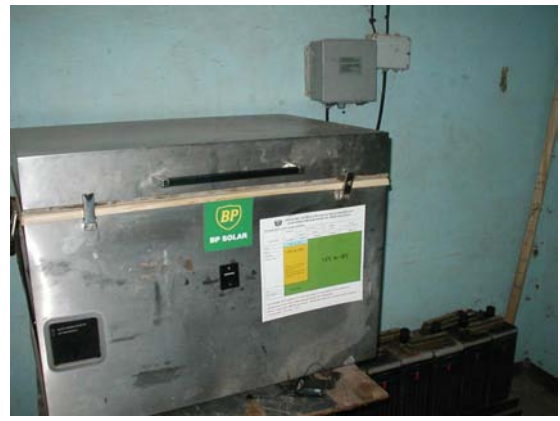
維持管理の必要な蓄電池バッテリー・冷蔵庫(同左)
