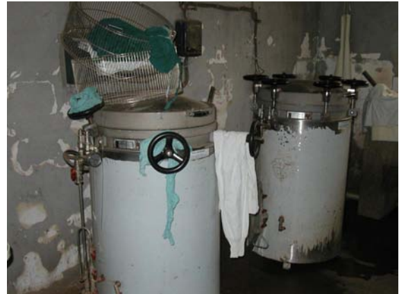
故障が頻発する老朽化した消毒器(州病院)
