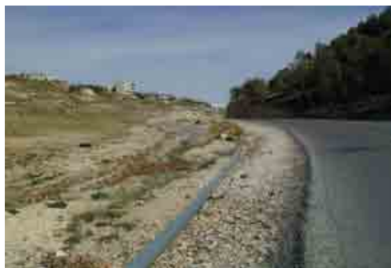
給配水管網を結ぶ導水管（Karak GWA） 80A SGP（道路脇の露出配管）
