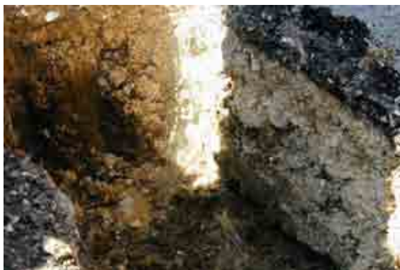
LEMA西部支所 (Amman) 漏水修理 (腐食による亀裂)
