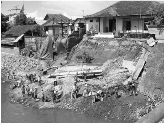
Badung 川 豪雨・洪水で護岸崩壊
