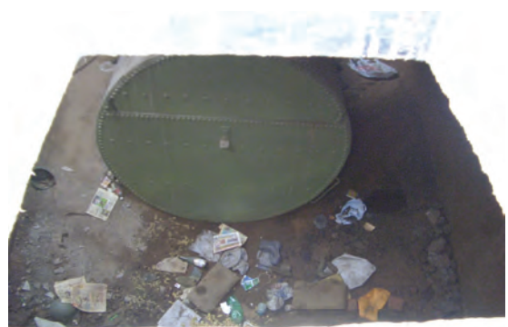
地下にあるタンク。建設予定サイト内に 2 つあることが確認された。
