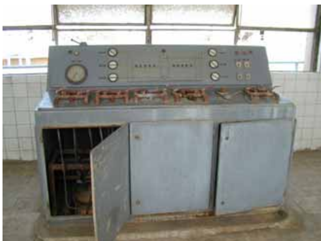
既設ろ過池手動式逆洗用操作盤
