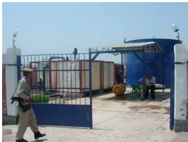
コンパクトユニット（簡易浄水場）：新旧浄水場から離れた周辺の村落への給水に大きな役割を果たしている
