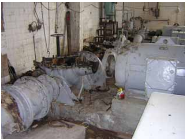
既設ろ過池用逆洗用ポンプと空気洗浄ブローア
