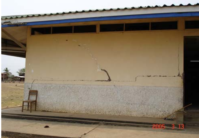
本館、妻壁にクラックあり（不同沈下）
