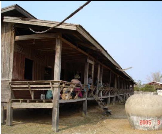
既存入院棟（木造高床だが床板が破損している）
