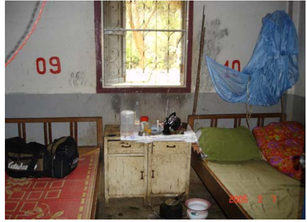
02 既存病室(汚れが激しい)
