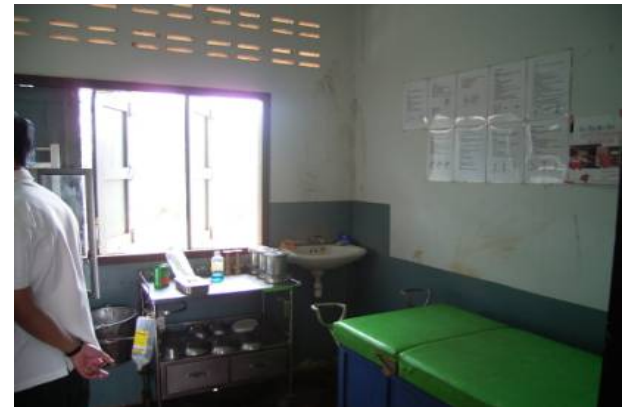
08 処置室(壁にクラックあり,マドは板窓である)
