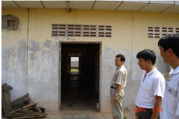
07 検査棟(クラックが入って危険な状態である)
