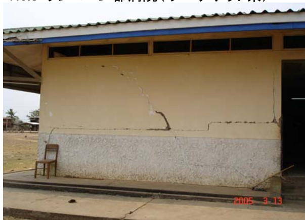
12 病棟妻壁(不同沈下によるクラック)
