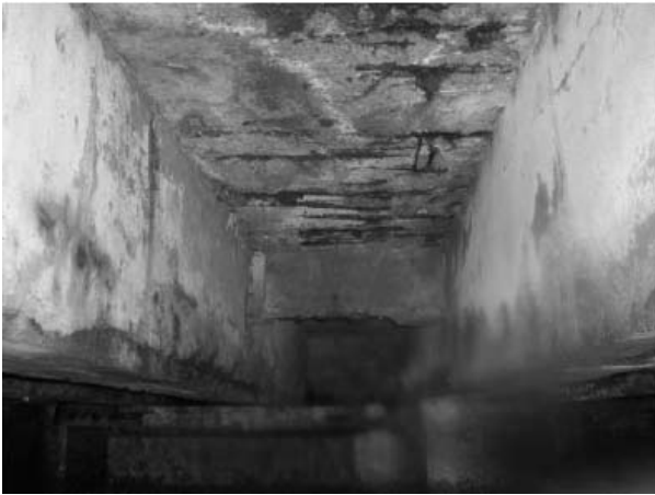
BL-9の床版の下側損傷状況 コンクリートが剥がれ鉄筋が露出している かぶり部分のコンクリート厚が不足している
