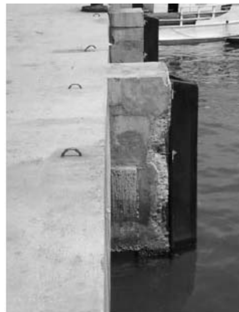
防舷材 台座部分が損傷している
