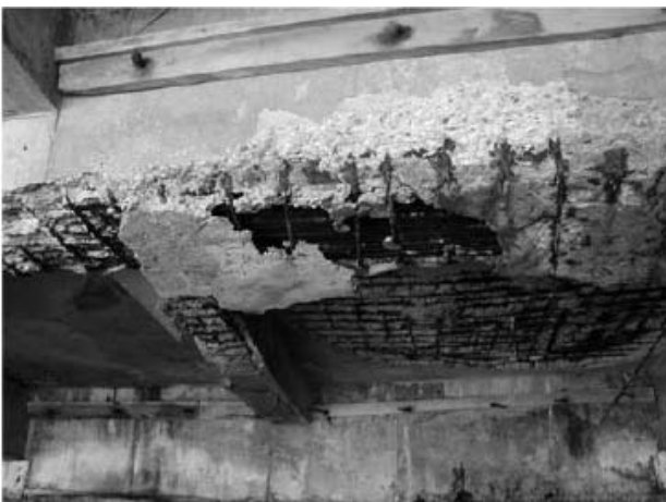
BL-1の床版及び梁の損傷状況
