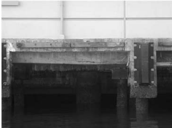
上屋前面 BL-4 の海側状況 法線平行方向の梁にクラックが見える
