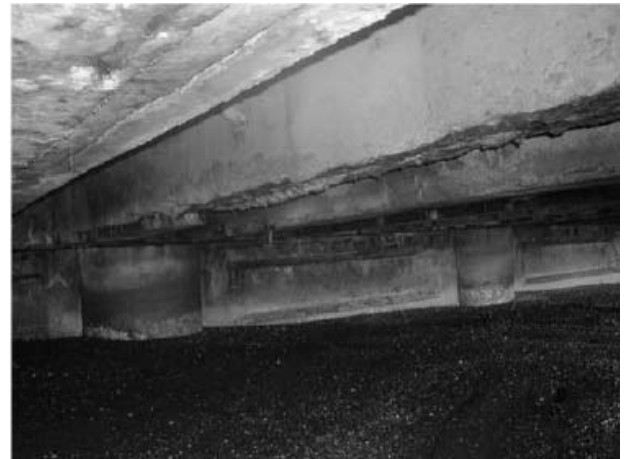
BL-9の梁の損傷状況 梁の下側のコンクリートが落下し主鉄筋が露出しており危険な状態
