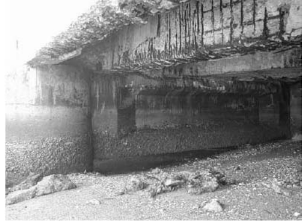
BL-7の床版の下側損傷状況 コンクリートが剥がれ鉄筋が露出している かぶり部分のコンクリート厚が不足している
