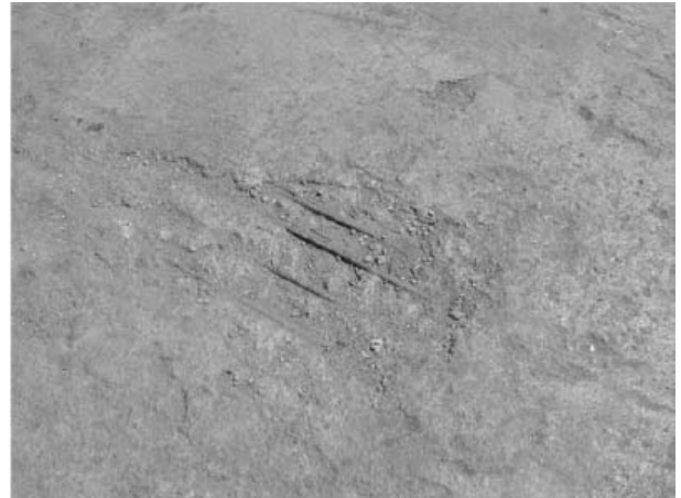
BL-4の床版上面の損傷状況
