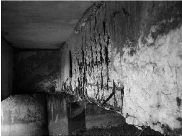
BL-7の梁側面の損傷状況 梁側面のコンクリートが剥がれ落下している
