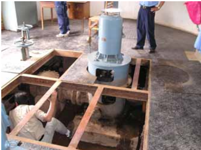
カオリオ浄水場 既設取水塔内にある取水ポンプ
