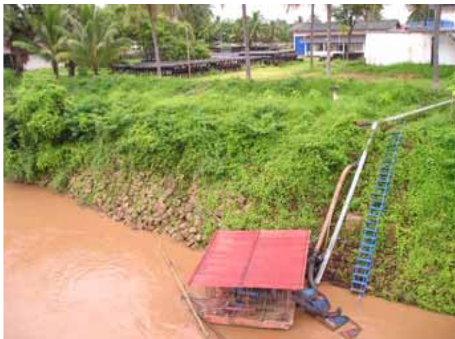
カオリオ浄水場 既設施設の取水量を増加させる ために応急的に設置された補助取水施設 (バージ船に取水ポンプが設置されている)
