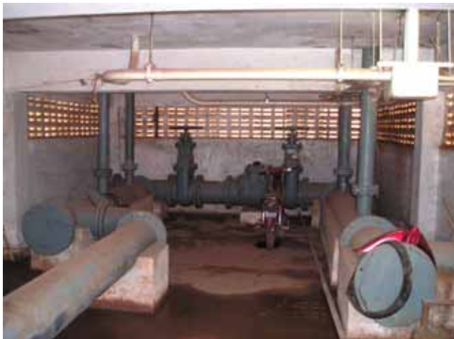
Km6増圧ポンプ場 1階 配水管
