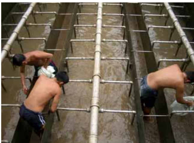
カオリオ浄水場 既設ろ過池 逆洗排泥時
