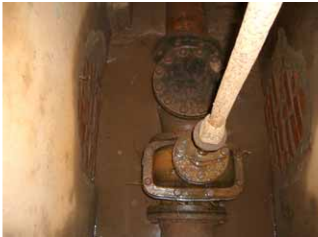
カオリオ浄水場 既設配水ポンプ仕切弁 (老朽化及び腐食が著しい)
