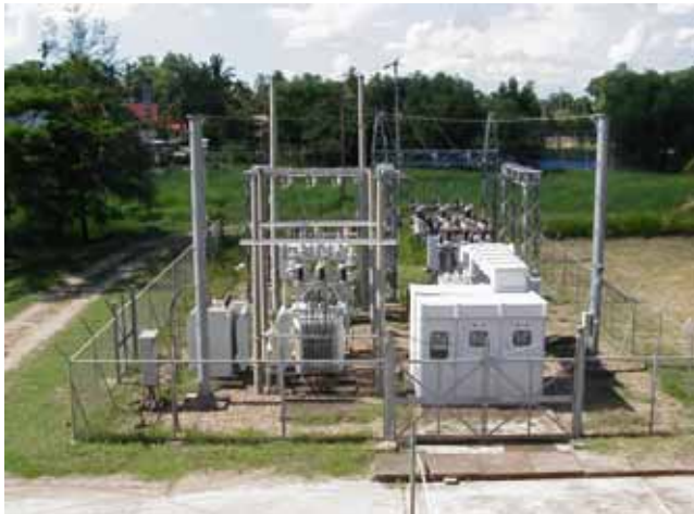
チナイモ浄水場 受電施設
