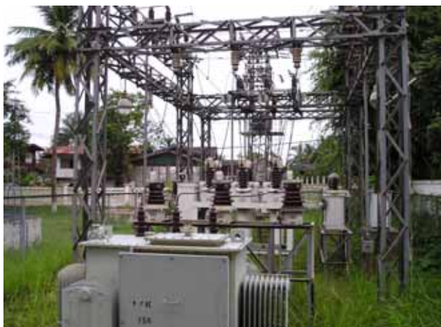
カオリオ浄水場 既設受電設備
