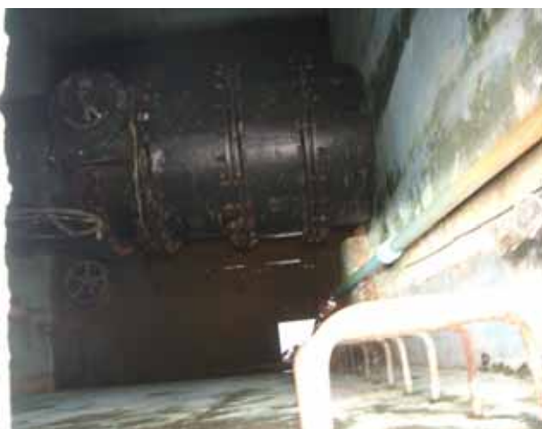
チナイモ浄水場 配水流量計室内
