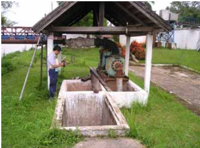
カオリオ浄水場 既設排水マス及び排水ポンプ
