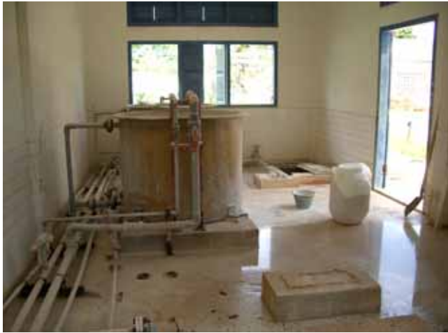
カオリオ浄水場 既設さらし粉混和注入施設
