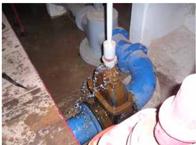
カオリオ浄水場 既設ろ過池管廊内 仕切弁 (老朽化し、数箇所水漏れしている)
