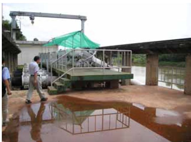
ドンマカイ灌漑用水取水ポンプ
