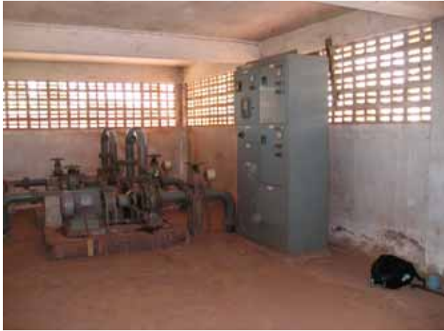
Km6増圧ポンプ場 2階 配水ポンプ
