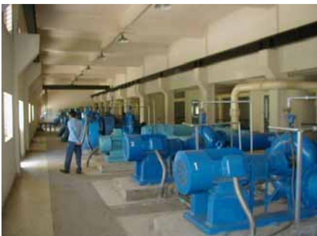
チナイモ浄水場 ポンプ施設
