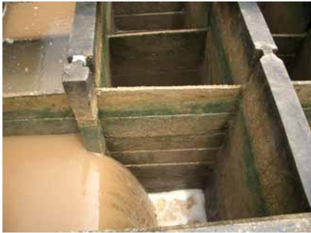
カオリオ浄水場 既設ブロック形成池 (沈澱池の排泥時)
