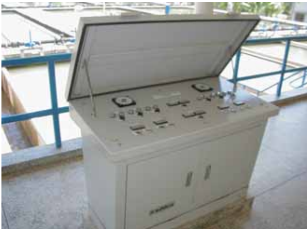
チナイモ浄水場 ろ過池操作盤
