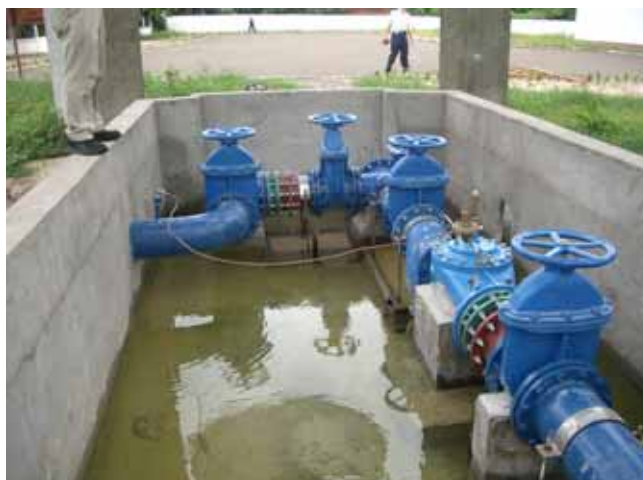
ノンテン高架水槽の流量制御弁 (施工に問題が多い)
