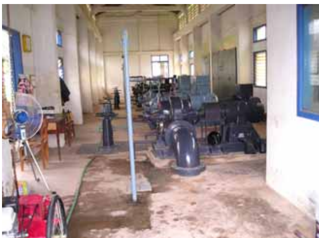
カオリオ浄水場 既設配水ポンプ場 (老朽化及び腐食が著しいため再塗装が行なわれた)
