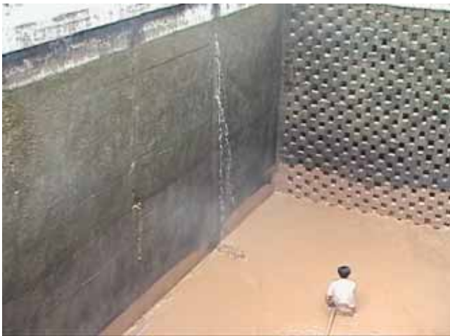
カオリオ浄水場 既設沈澱池 排泥の様子 (壁に亀裂が入っており、隣の池から水が漏れている)
