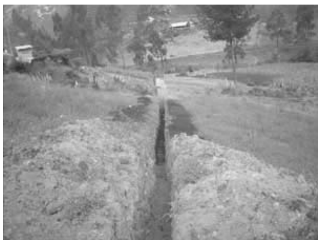
Proyecto conjunto de excavación de canal de agua entre los pobladores y el CREA a través del Programa de Asistencia Financiera No Reembolsable para Proyectos Comunitarios de Seguridad Humana.
