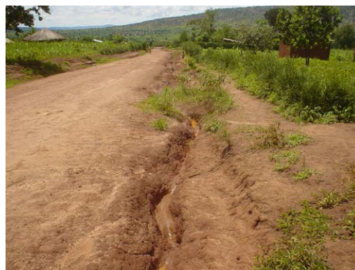
Erosion à la périphérie des terres
