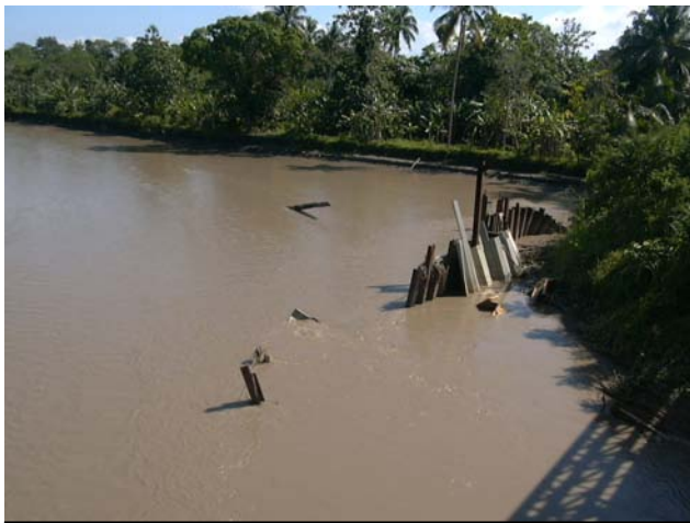
左岸レイ側上流の河岸侵食部分 応急処置を行ったが現在はその効果が見られない
