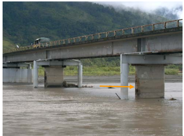
左岸レイ側の補修された橋脚 撮影時(8/16)の水位の約 1m 上にフラッド・マークが見られる
