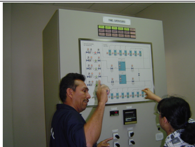
マナグア市上水道施設整備計画② 訪問日には5台の配水ポンプのうち4台が稼働しており、計画 水量の90%にあたる64,000m 3 /日を生産していた。
