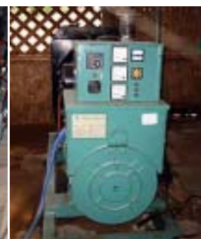
Diesel Generator for Mini Grid (Viengphouka)
