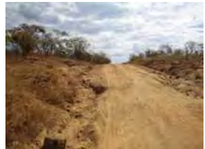
縦断勾配の大きい区間で見られる浸食
