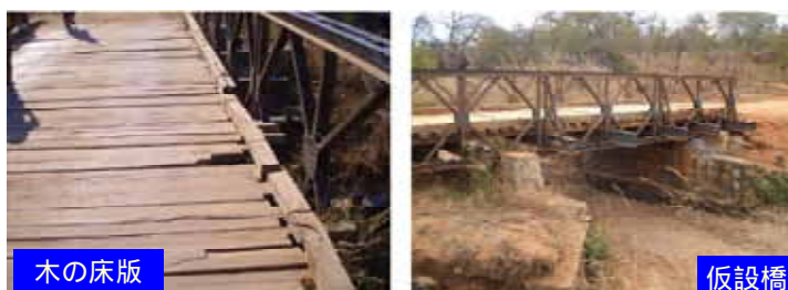
写真 仮設橋（ベリー橋） 仮設橋の床版は木製であり損傷が著しい。
