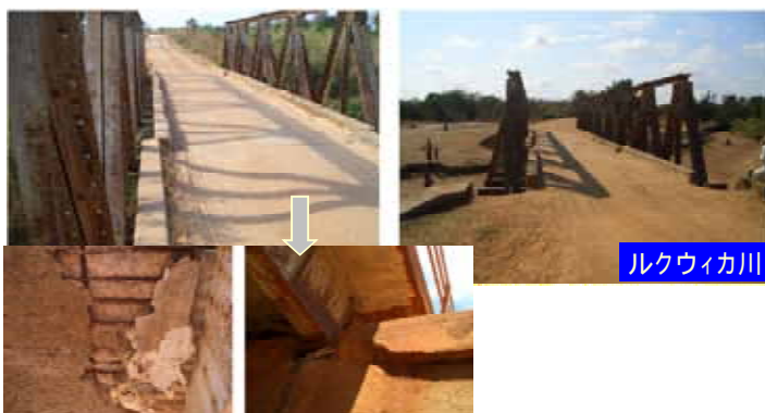
写真 ルクウィカ橋の状況 床版の裏面は既に鉄筋が剥きだしとなっている。床版自体もずれている状況。
