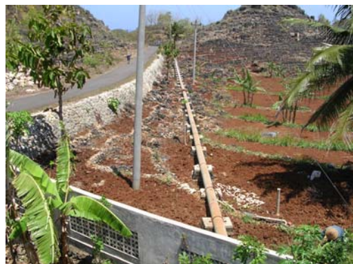
既存ノゴバラシシステム 送水管
