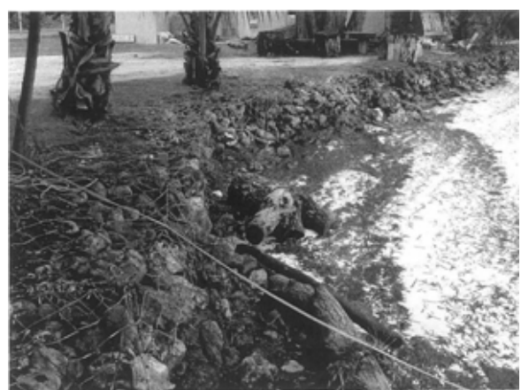
西側護岸のガビオン(護岸構造体)の破損
