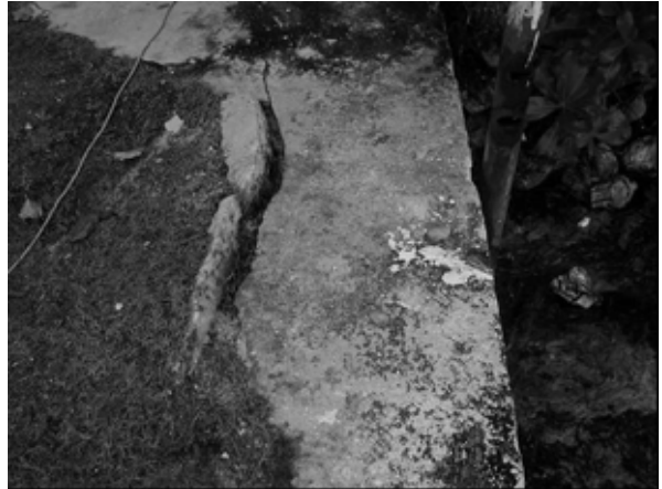
西側岸壁の場所打ちコンクリートの破損状況
