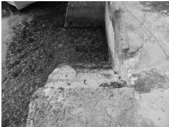
西側護岸階段部分のコンクリートの劣化
