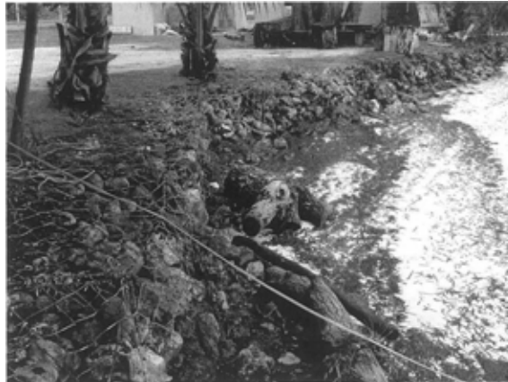
写 3.1.3(2)-7 西側護岸のガビオン(護岸構造体)の破損状況
