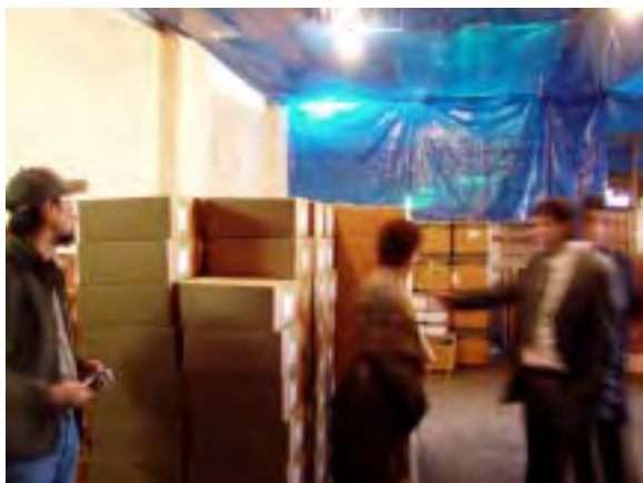
ラパス CEASS 保管庫の現況 雨漏りを防ぐためシートを天井に張っている。
