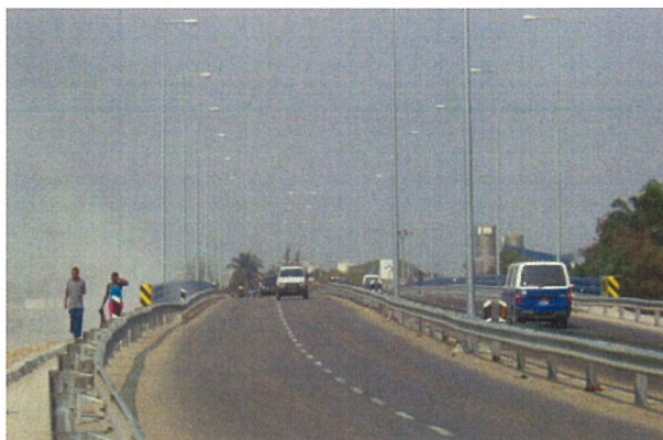
ロビト側橋詰めより望むカバコ橋の橋面。路面には凹凸が見られる。
