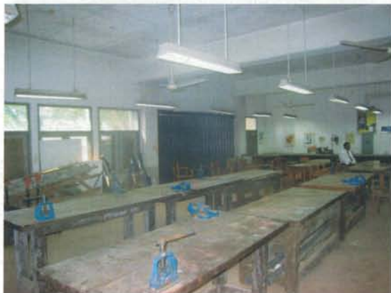
1階：金属加工 溶接技術(1) 壁や天井のペンキ塗り、照明器具等の修繕が必要。床の状態はよい。
