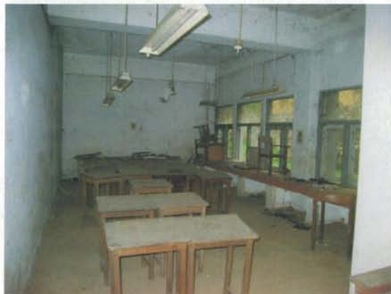
1階：金属加工 溶接技術(5) 壁や天井のペンキ塗り、照明器具等の修繕が必要。床の状態はよい。
