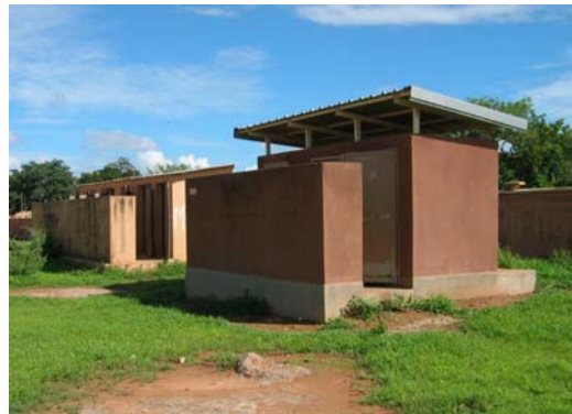
トイレ外観 (全部の扉の取っ手・鍵が壊れている)
