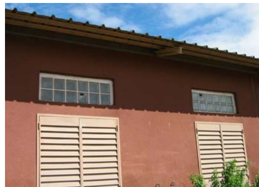
ガラスブロック窓 (損傷している箇所が多い)
