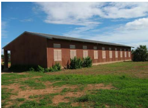
教室棟の背面 (全体的に施設の維持管理状態が悪い)
