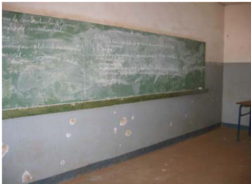
教室内部 (壁面のペンキ・モルタルの傷みが多い)
