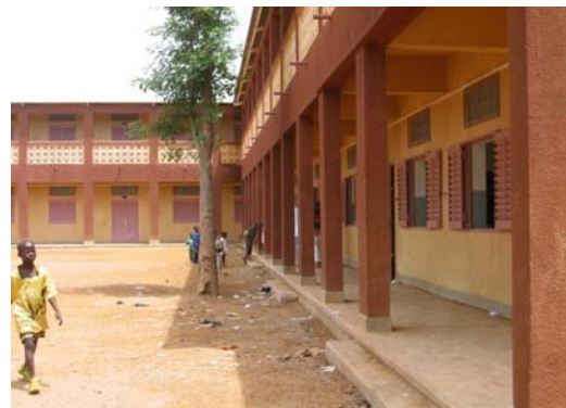
廊下 (全体的に施工が粗い印象)
