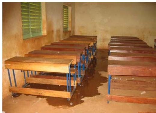
中学校教室内部（廊下から雨水が流入した床）
