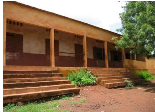
小学校教室棟（老朽化が進み、危険なため使用中止）
