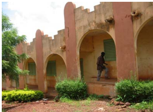
中学校教室棟の廊下側（建物がかなり傷んでいる）
