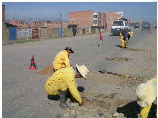
PROVIAL の零細企業による恒常的維持管理作業 3 (アスファルト路面の仮補修)
