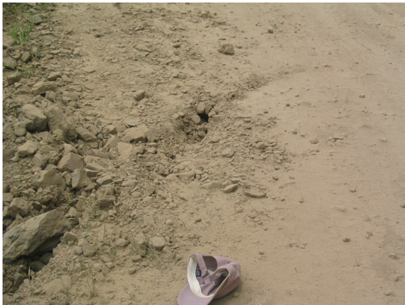
「地点 3-7」 谷側路肩に亀裂が入っており、谷側道路の崩壊の危険性が高い。
