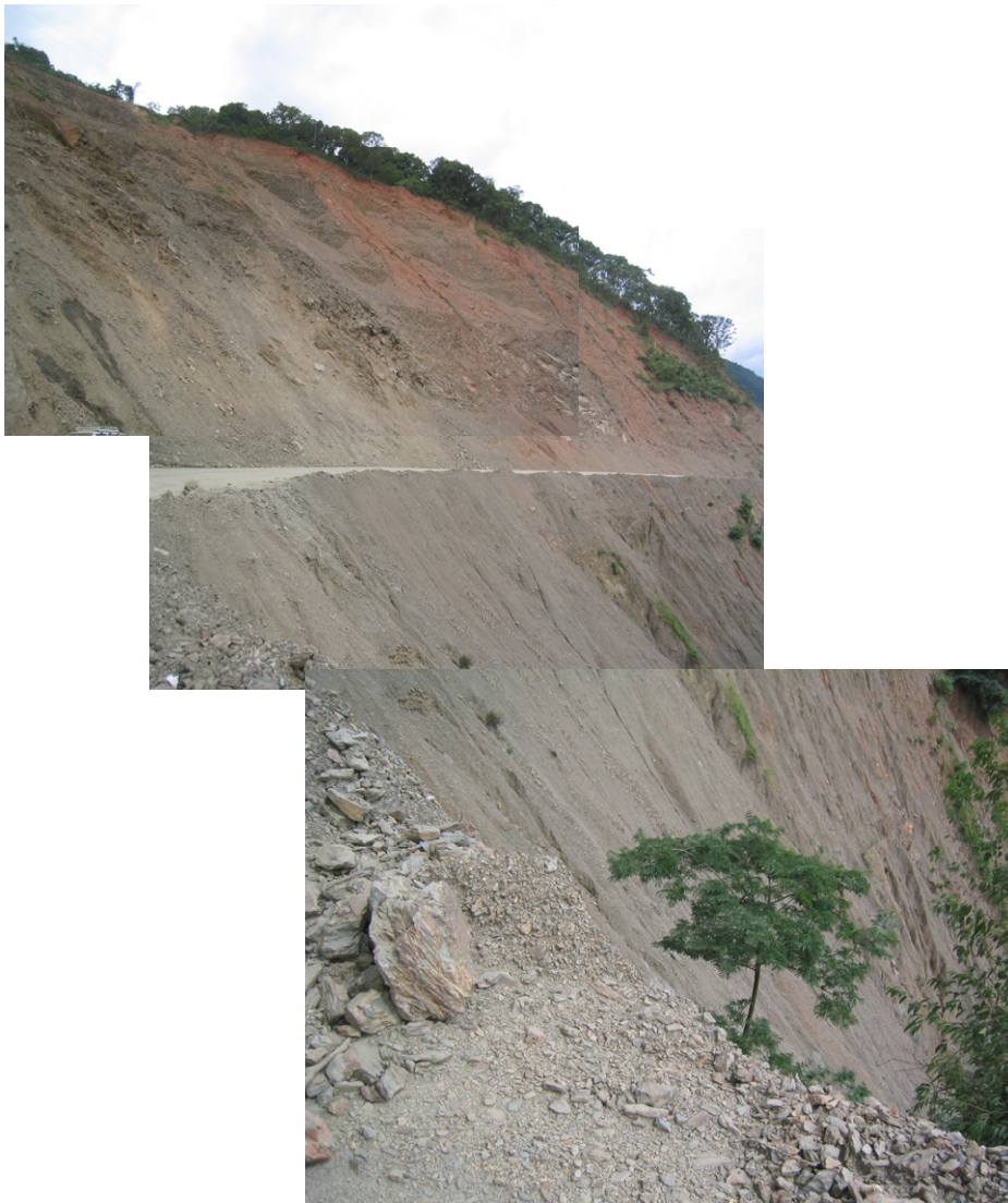
「地点 3-2」 起点コタパタより 91.5km (サンタバルバラより 48.5km) 谷側崖は急斜面でかつ非常に深い。
