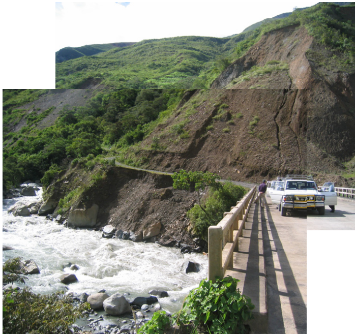
「地点 16-1」 チャラサニより 34.0km 地点。 谷側斜面に RC 擁壁を設置すべきである。
