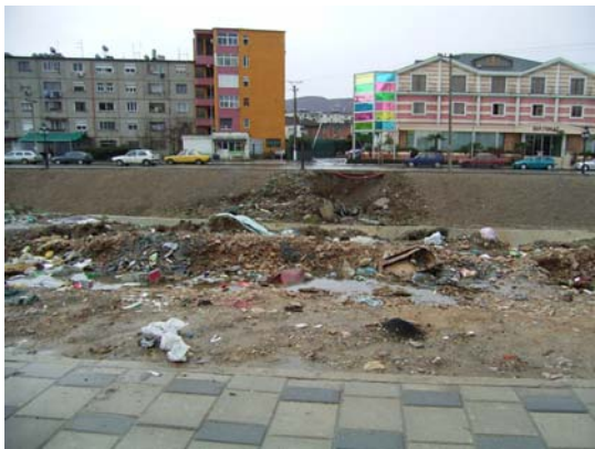
ラナ川中流部下水管吐口法面の崩落
