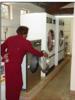
ランドリー(洗濯機 + 乾燥機)
