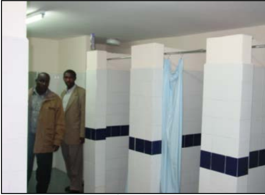
宿泊棟共同シャワーブース
