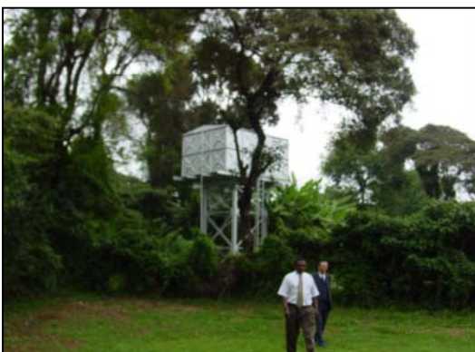
高架水槽 新旧2つの井戸から汲み上げて貯水している。43m3
