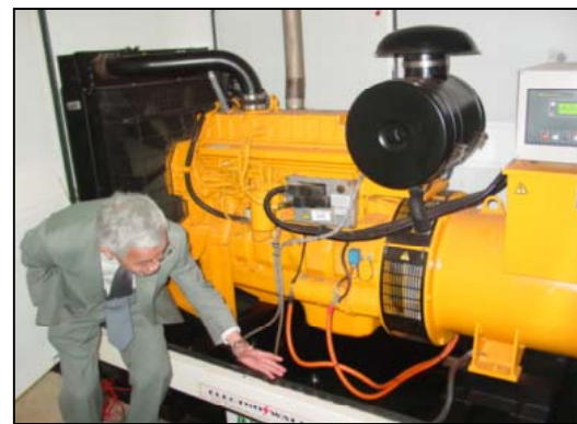
ジェネレーター (サブステーション)
