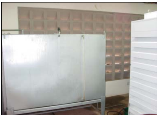
ジェネレーター用オイルタンク
