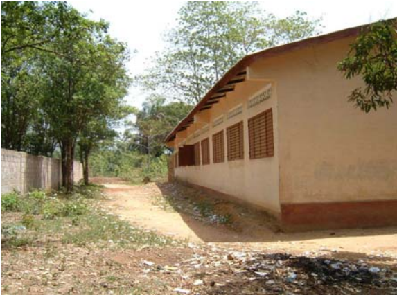
コヤ県、Soumaya Centre小学校 (世界銀行により建設、1972年建設、PPTEにより2003年改修済み、教室棟外観)
