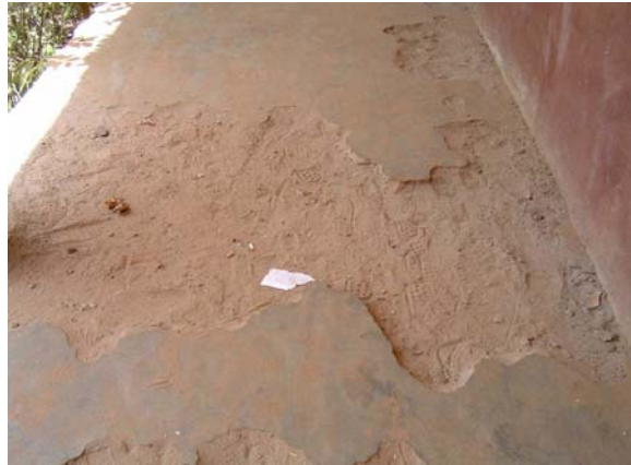
コヤ県、Soumaya Centre小学校 (外部廊下床モルタル部の剥離が深刻)
