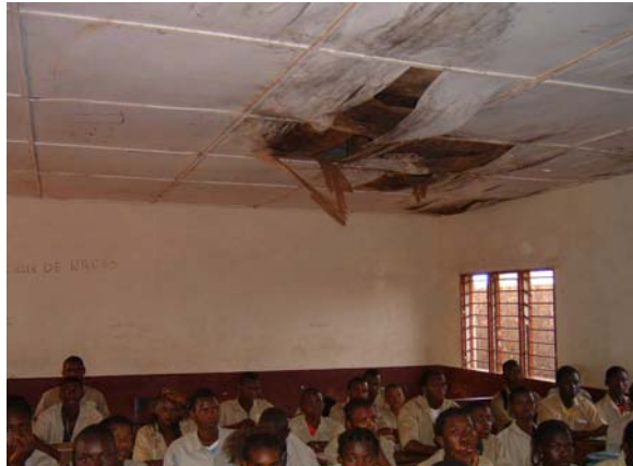
コナクリ・ラトマ区、College Koloma (既存教室内部、天井板が雨漏りによる腐れで落下)
