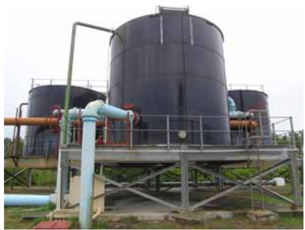
EU 援助によるローズホールの浄水施設。手前のタンクで空気を吹き込んで鉄分を酸化し、奥のタンクで濾過して除去する仕組み。
