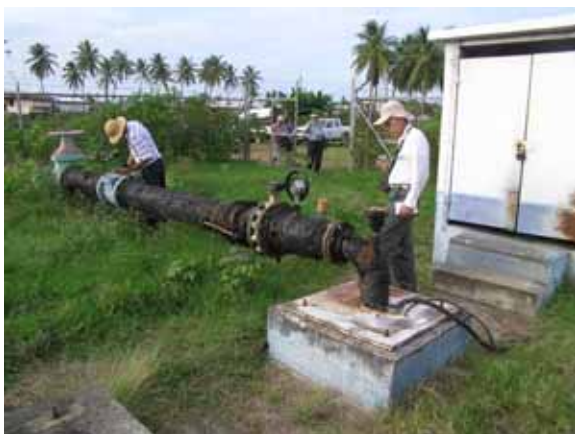
水源として使われている井戸とポンプ場。このようなポンプ場が 9 ヶ所あり、直接配水管につながっている。
