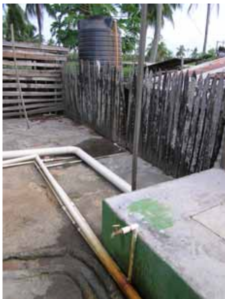
敷地内の水道配管。奥の黒い貯水タンクに一度水を貯めている。タンクにも蛇口の下のパイプにも、赤茶けた鉄錆が付着している。
