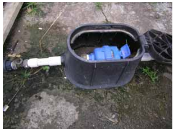
家庭への引き込み管に取り付けられた水道メーター。現在は設置率が低く、ガイアナ水道公社は普及に努めている。
