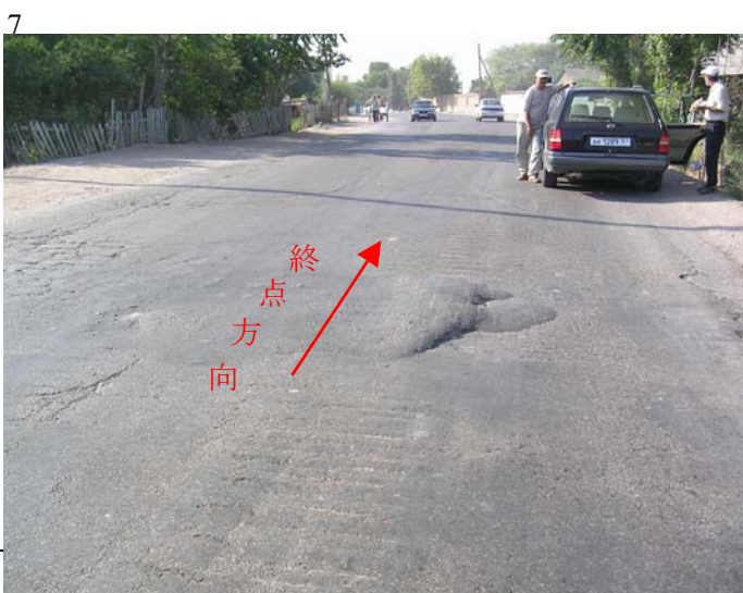
り劣化した現況。
